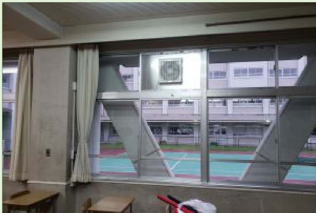
某学校 換気扇パネル
